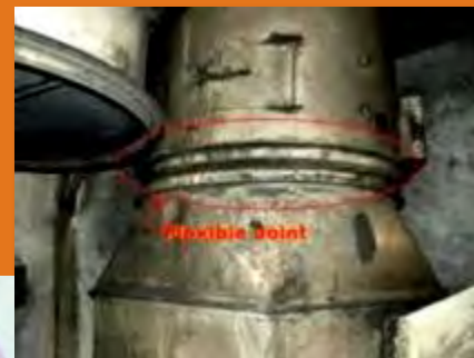
空調系統管道避震接口
