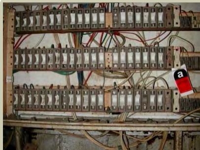
電掣箱絕緣墊片
