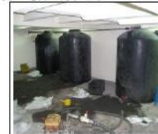
化學廢液儲槽區
